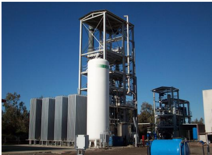
Figura 1.1. La piattaforma pilota Sotacarbo.
