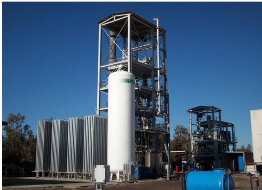
Figura 1.1. La piattaforma pilota Sotacarbo.
